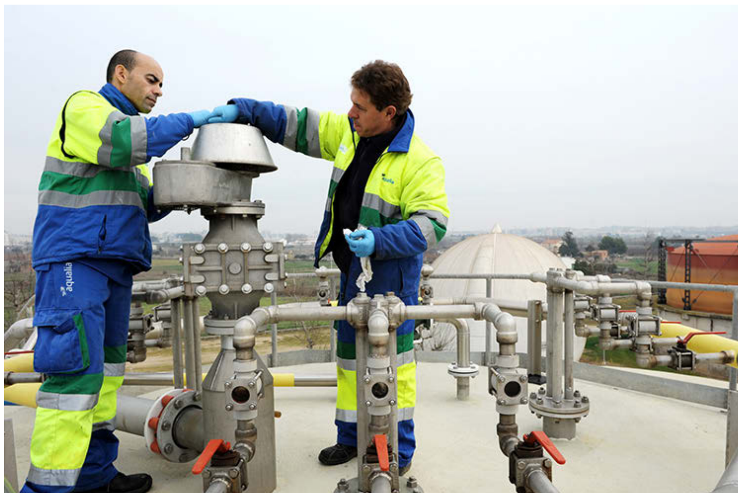
Operarios de la Estación Depuradora de Aguas Residuales en Lleida. eE
